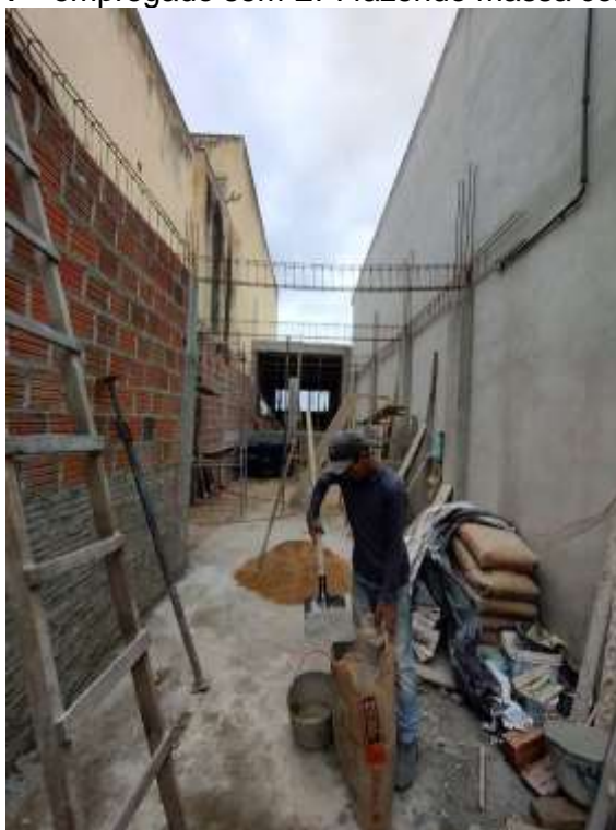
Figura 04 – empregado sem EPI fazendo massa com cimento
