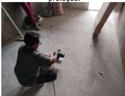
Figura 03 - Trabalha na construção civil há mais de 30 anos e está cortando piso sem proteção.
