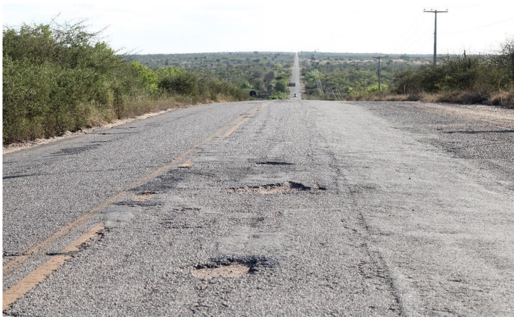
Figura 02 – Patologias de pavimentos flexíveis – Desgaste.
