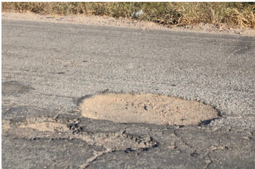
Figura 03 – Patologia de pavimentos flexíveis: Panela ou buraco.
