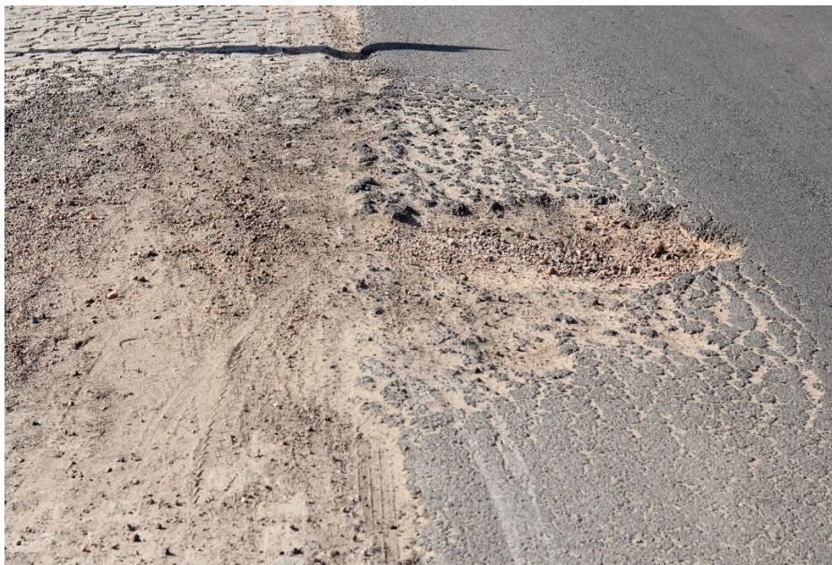
Figura 05 – Patologia de pavimento flexível: Trinca tipo couro de jacaré.
