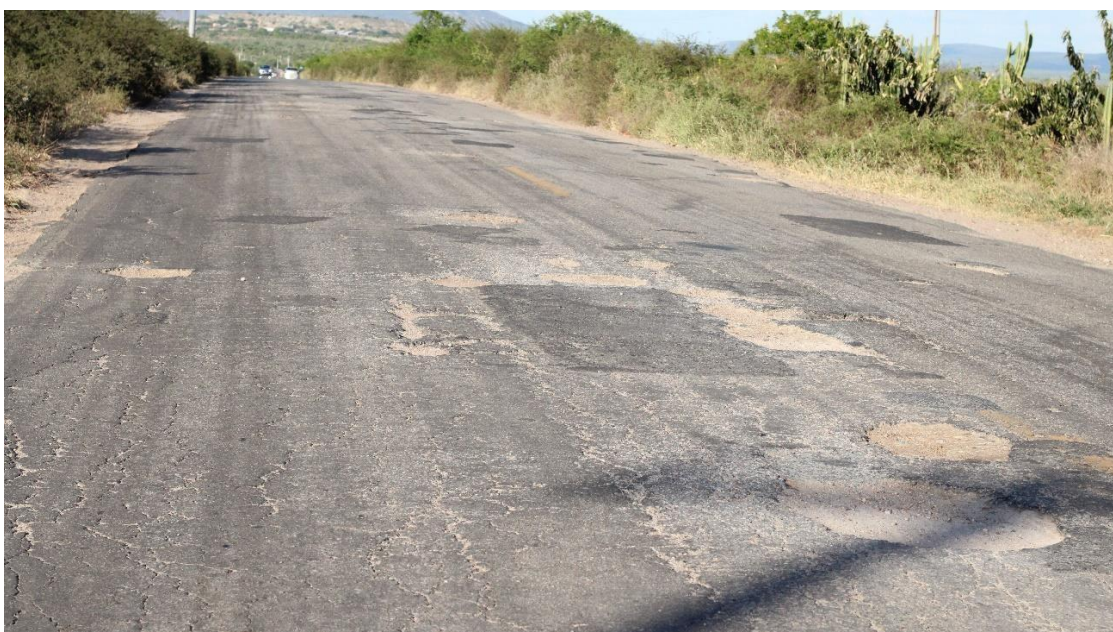
Figura 06 – Patologias de pavimentos flexíveis- remendo.
