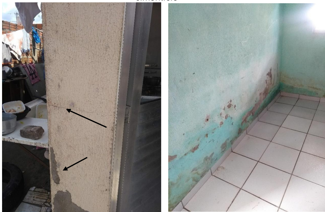
Figura 6. Manchas e desagregação do revestimento cimentício
