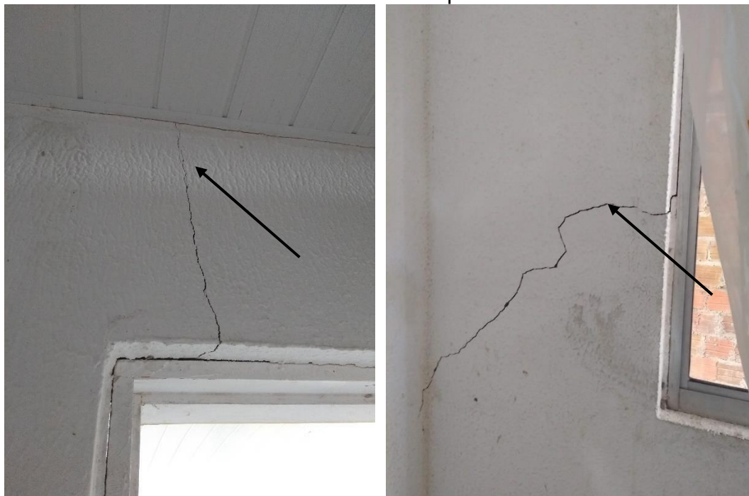
Figura 3. Fissuras na alvenaria, (a) vertical em verga da porta; (b) diagonal saindoda esquadria
