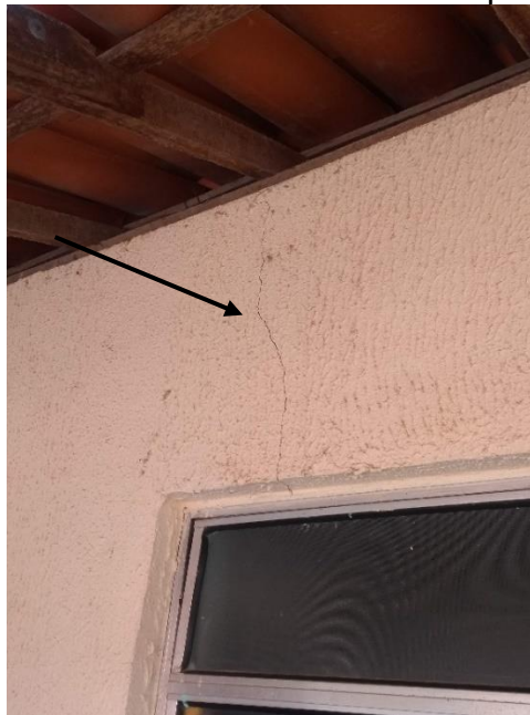
Figura 5. Fissura vertical acima da esquadria
