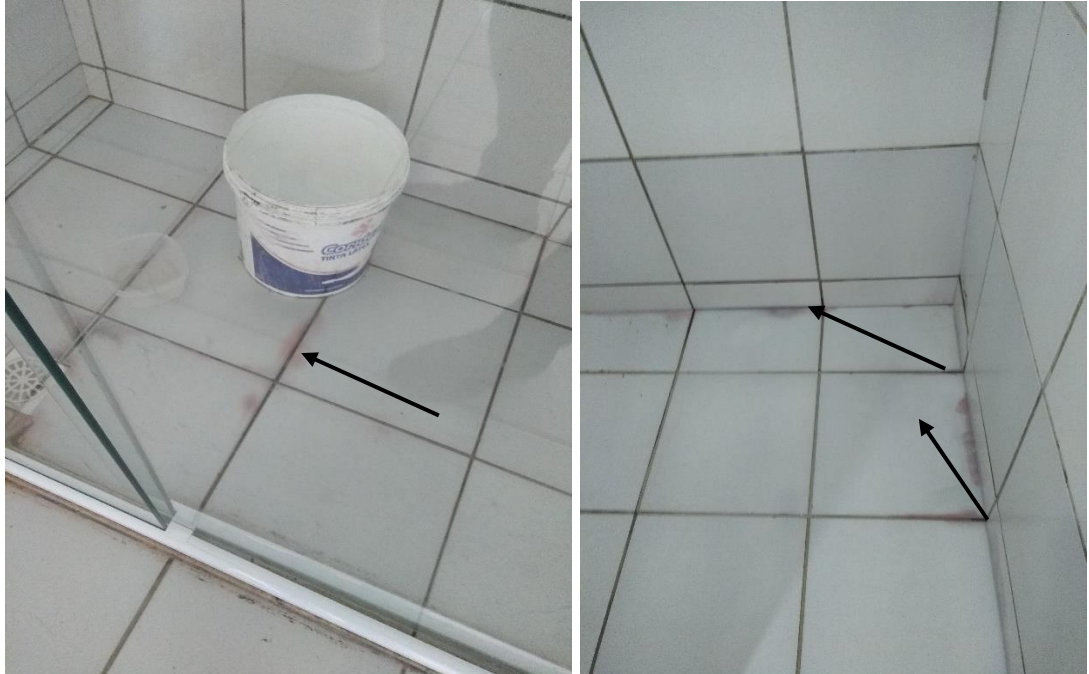
Figura 9. Manchas no revestimento cerâmico em banheiro
