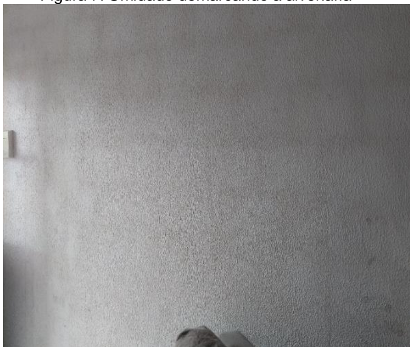
Figura 7. Umidade demarcando a alvenaria
