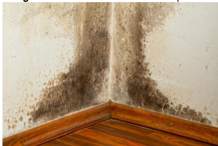
Figura 01- Bolor/Mofo localizado no quarto
