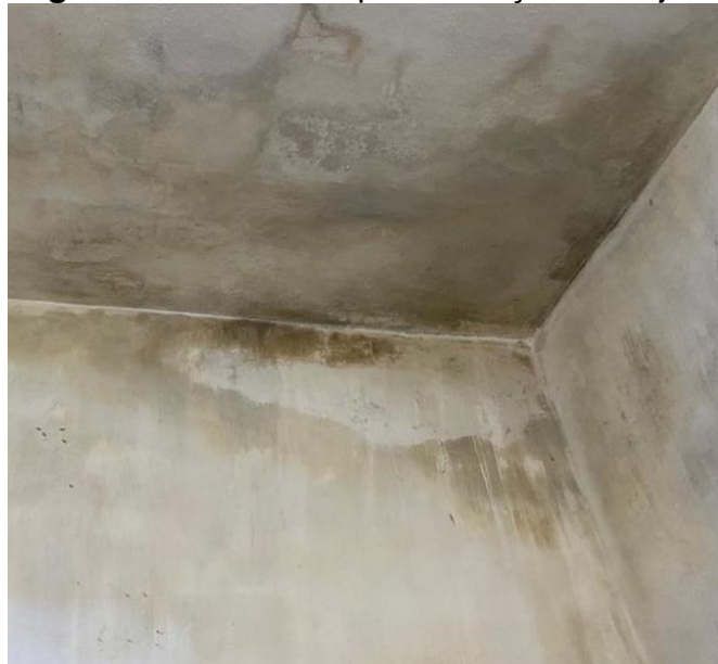
Figura 04 – Umidade por infiltração em laje
