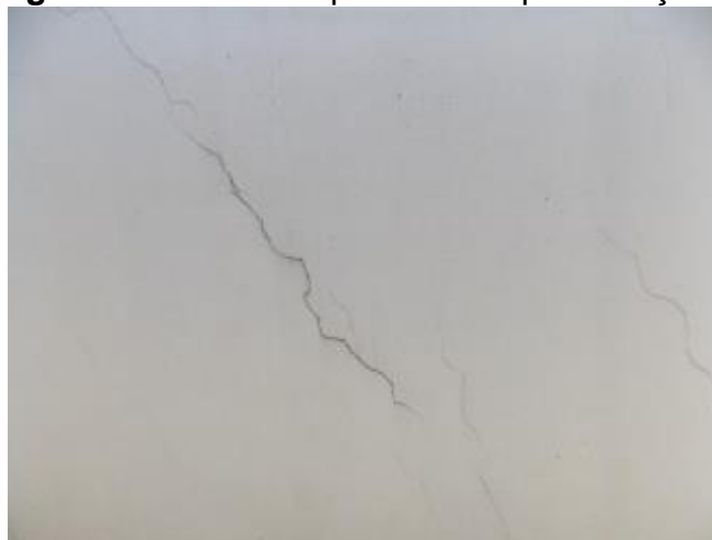
Figura 03 – Fissuras provocadas por retração
