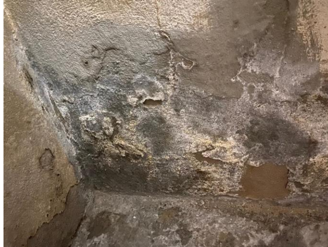
Figura 02 – Eflorescência em parede
