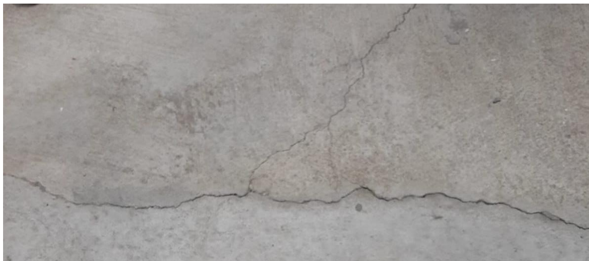
Figura 1 - Fissuras Em Todo O Piso Concretado No Espaço Educativo Urbano De 12 Salas Com Quadra Do FNDE
