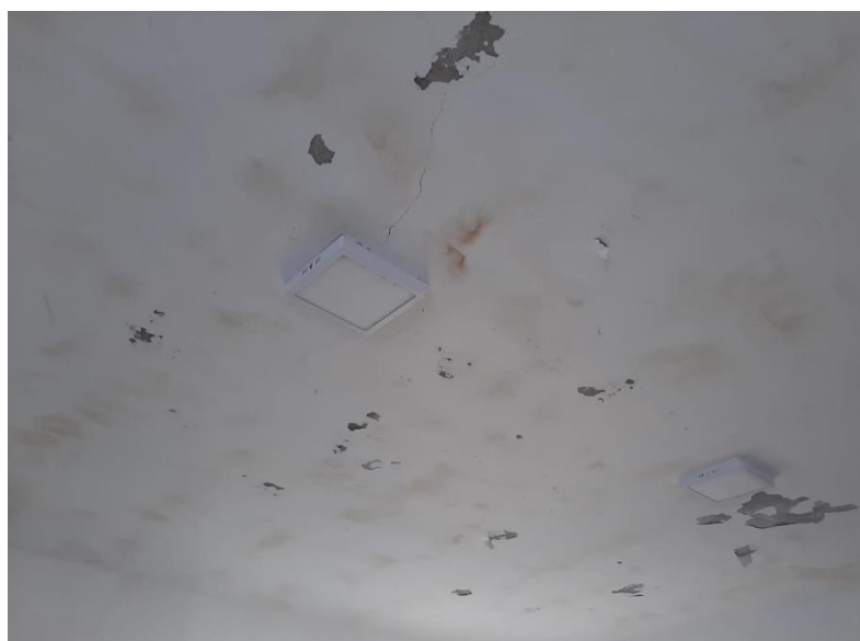
Figura 6 - Infiltração Da Laje Do CREAS
