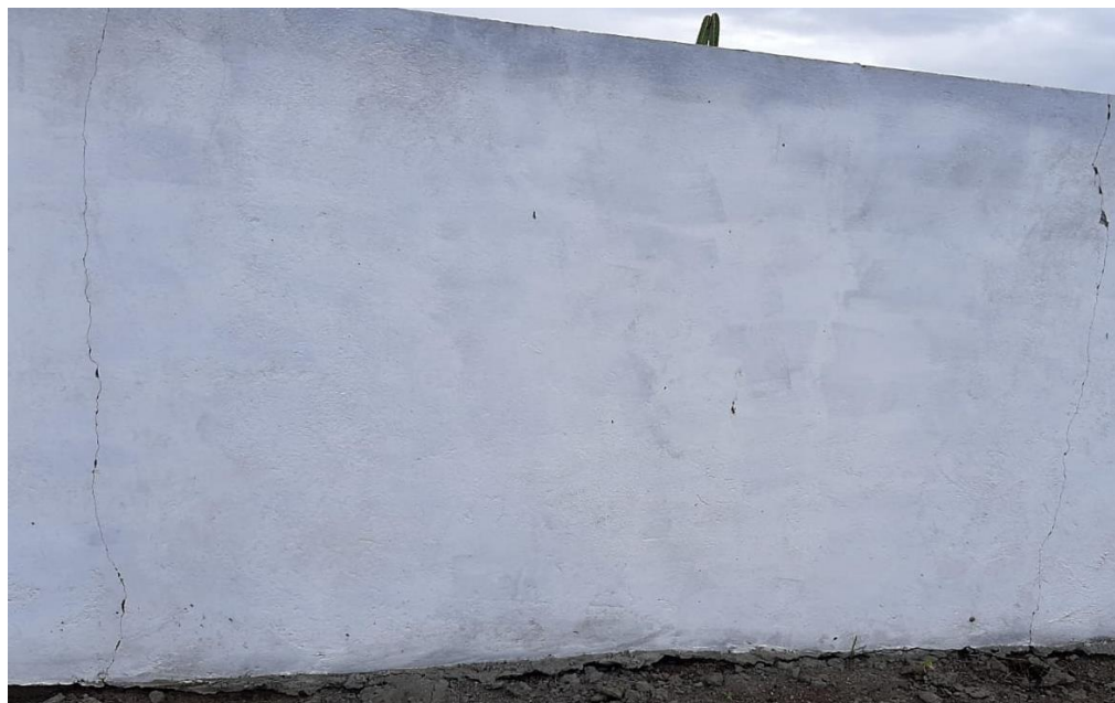
Figura 4 - Fissuras Ocasionadas Por Falta De Pilares No Distanciamento Correto
