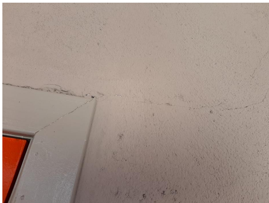
Figura 2 - Patologia Em Decorrência Da Ausência De Verga Na Estrutura Do Espaço Educativo Urbano De 12 Salas Com Quadra Do FNDE
