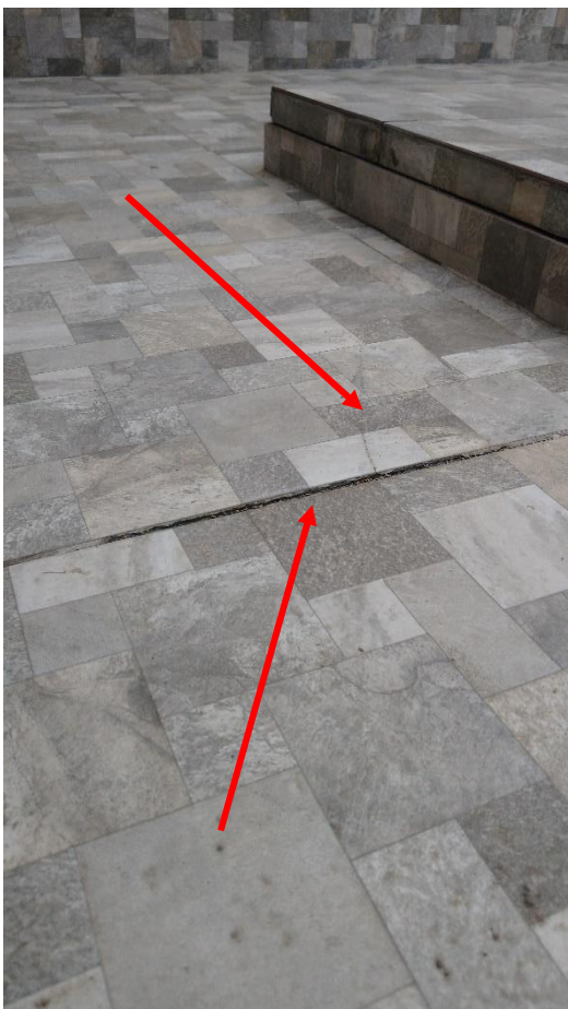
Figura 6- Fissura no revestimento cerâmico e descolamento do piso.
