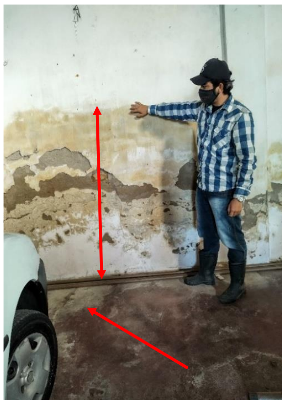
Figura 4- Umidade na alvenaria e eflorescência no piso.
