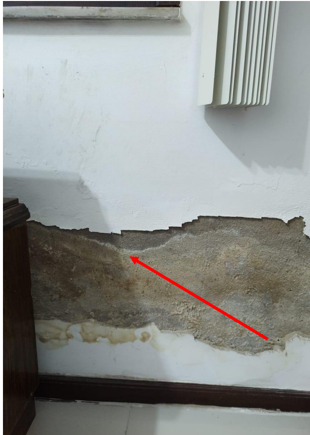
Figura 5- Descolamento da tinta e presença de eflorescência.
