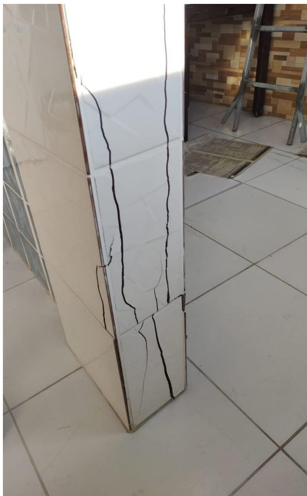
Figura 12- Rachaduras no revestimento cerâmico do pilar.
