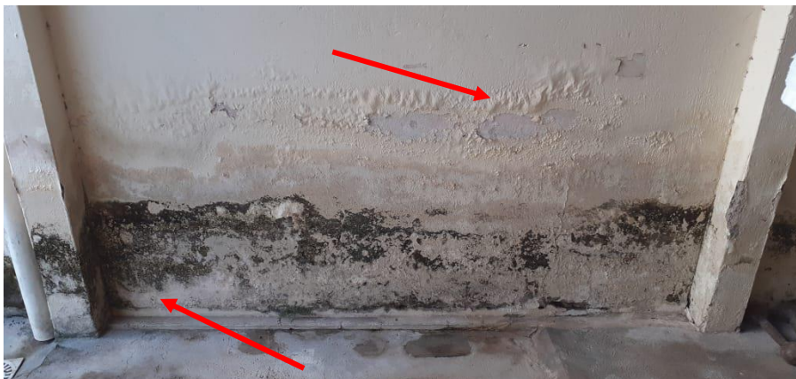
Figura 2 – Presença de bolhas e mofo.
